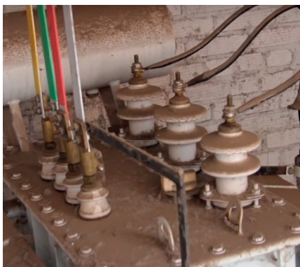
Рис. 8. Изолятор трансформатора до вакуумной чистки
