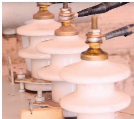
Рис. 9. Изолятор трансформатора после вакуумной чистки
