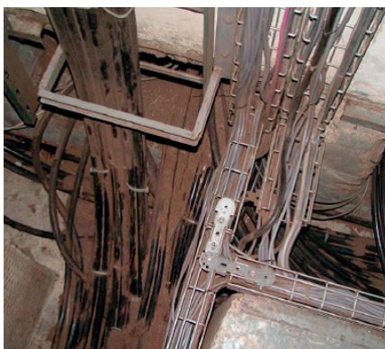
Рис. 5. Каналы ТП до очистки
