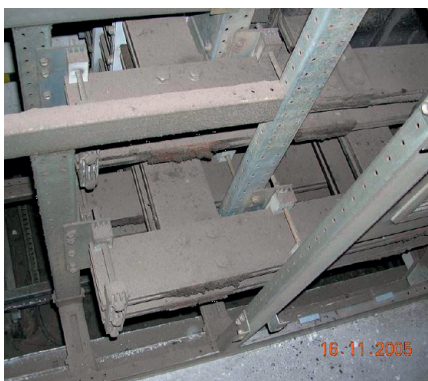
Рис. 3. Ячейка ТП до очистки
