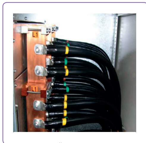
Рис. 2. Ячейка ТП после очистки
